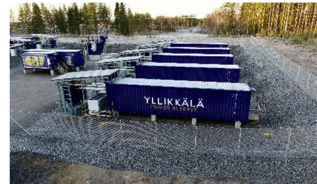
Yliikkälä – 30 MW / 30 MWh - Finland
